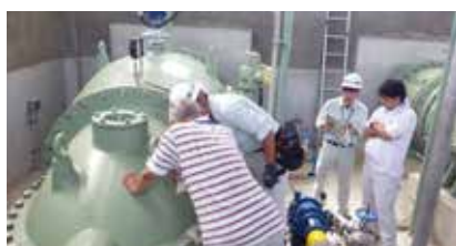
横江排水機場
