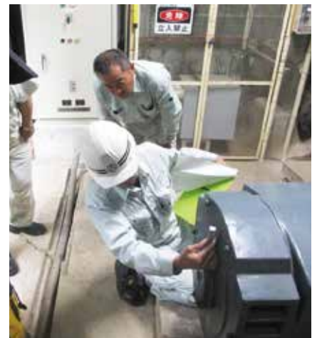
揚水ポンプモーターの振動数測定状況
